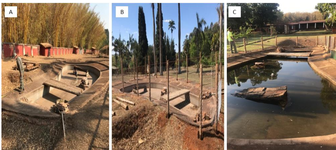
Figura 5: A: início da construção do recinto novo para os jacarés. B: processo de construção do recinto para os jacarés. C: Jacarés já introduzidos no recinto novo.
